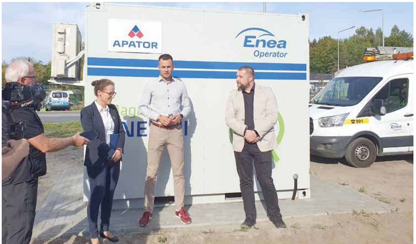
ENEa Operator z nowym magazynem energii w sieci niskiego napięcia
