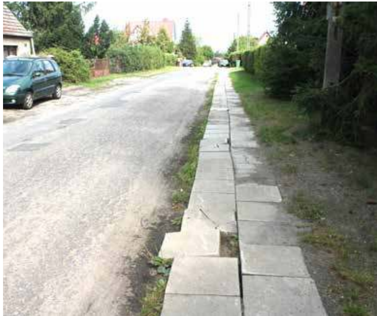
Niektóre płyty chodnikowe ulegają degradacji i zaczynają nieestetycznie wystawać poza krawędź chodnika (zdjęcie z sierpnia 2021)
