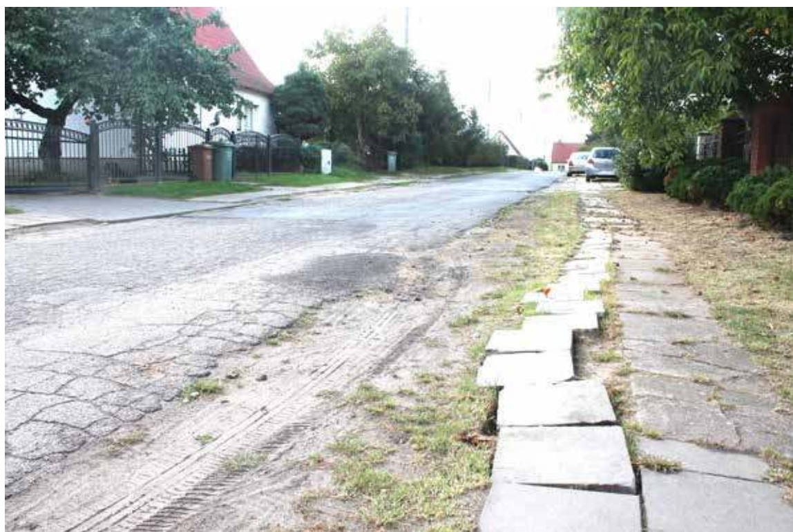
Zdjęcie chodnika i nawierzchni drogi na ul. Kossaka wykonane wczoraj, tj. we czwartek 5 października
