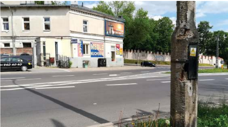
Przy ul. Bernardyńskiej rozsypują się betonowe latarnie
