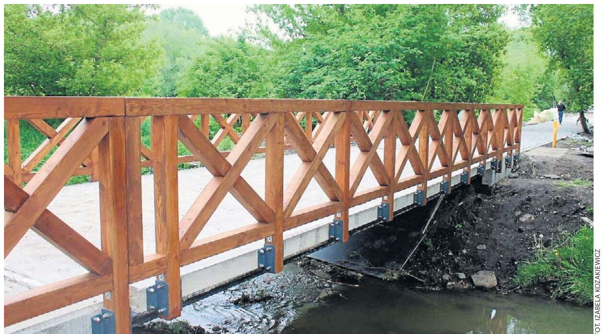
Kładka nad Mleczną między Piotrówką a Zamłyniem jest już wybudowana. Trwa układanie nawierzchni.
