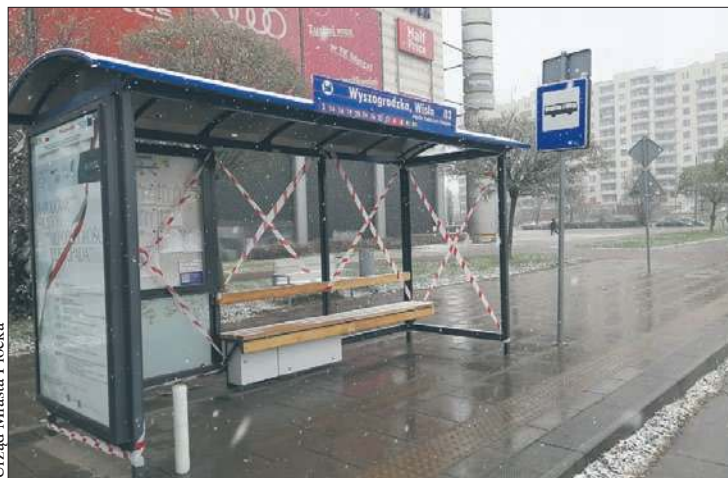
Uszkodzona przez wandalę wiatra przystankowa przy al. Jana Pawła II
