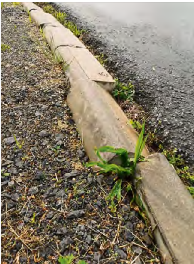
Uszkodzony krawężnik na skrzyżowaniu ulic Meblarskiej i Osiedle Fabryczne obrazuje problem zbyt cięskiego łuku drogi, na którym samochody ciężarowe nie mieszczą się podczas skrętu.
