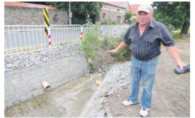
Pan Adam wskazuje na źle wybudowany mur oporowy, który strumień wody będzie kierował na skarpe drogi. Na końcu lewego muru widać małe drzewko, którego tu nie powinno być
