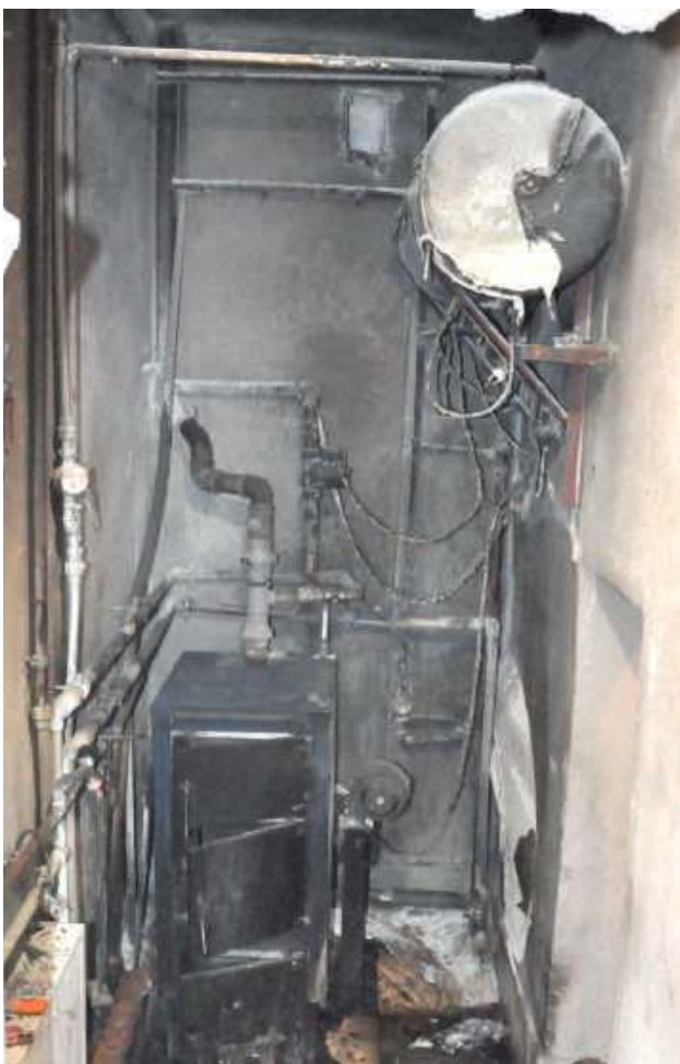
Pożar poważnie zniszczył kotłownię
