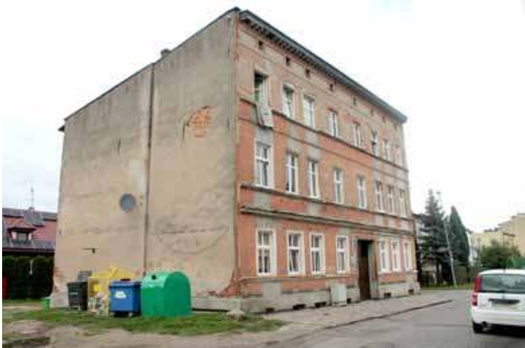
Podobnie wygląda sytuacja z budynkiem na przeciwko. Miasto zapowiada częściowe remonty, więc może i ten budynek zostanie do nich włączony
