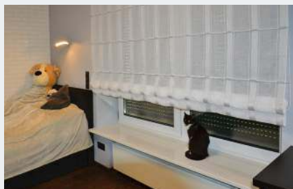
Przez rozszczelniony pancerz wpada do pomieszczeń niedużo światła.
