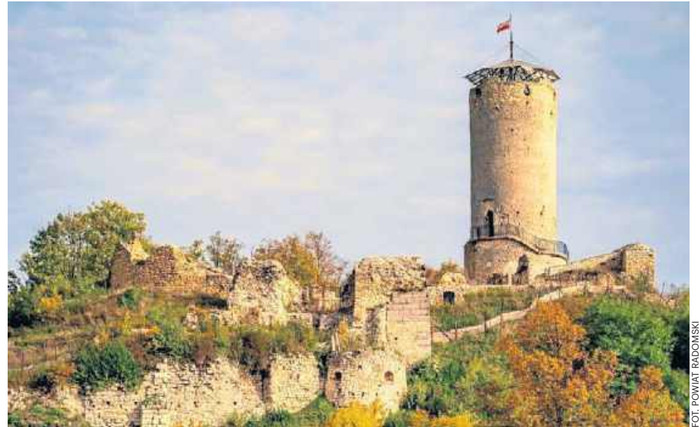
Gmina Iłża dostała dofinansowanie na naprawę wcześniejszej renowacji. Chodzi między innymi o rozsypujące się korony nadbudowanych murów.
