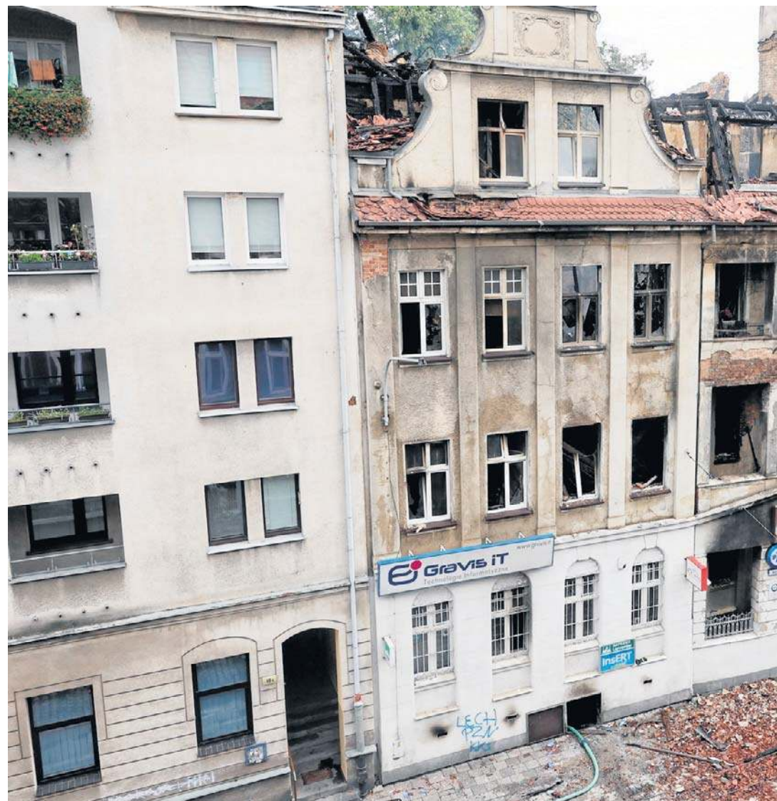
Pożar, który wybuchł w nocy z soboty na niedzielę doszczętnie zniszczył kamienicę
