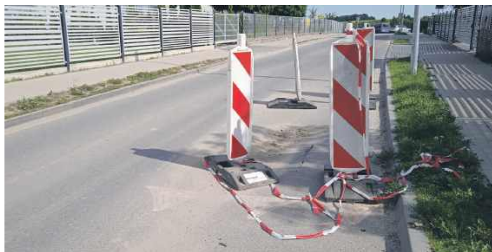
Zabezpieczenie zapadliska pachołkami urzędnicy uznali za wystarczające.
