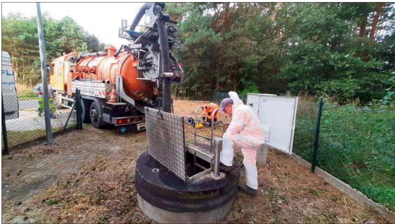
Pompy są sercem przepompowni ścieków.
