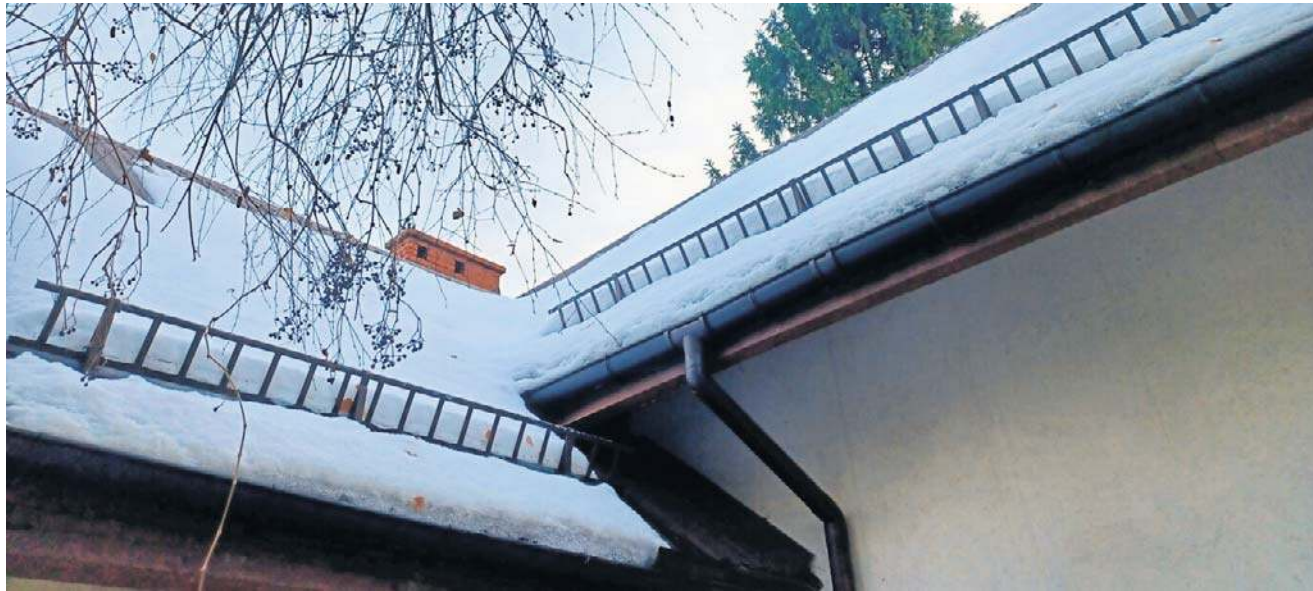
Bariery przeciwnieźne na dachu zapobiegają gwałtownemu zsuwaniu się mas śniegu z połaci.
