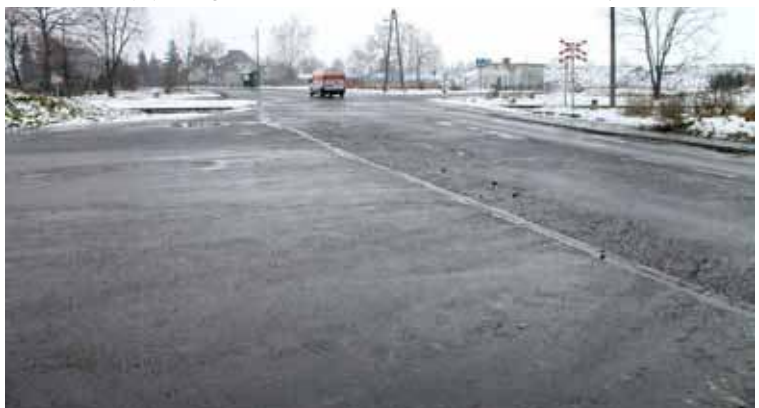
Remontu wymaga nawierzchnia na prawie całej powierzchni drogi. Miasto chce pozyskać na to środki zewnętrzne
