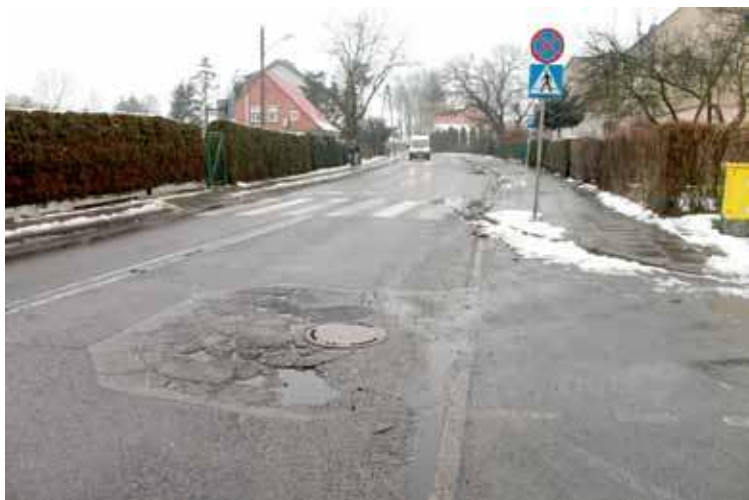
Jadąc ulicą Lotników miejscami trzeba bardzo uważać, by nie wpaść kołem w taką oto dziurę. Prace naprawcze mają się zacząć, gdy pozwoli na to pogoda
