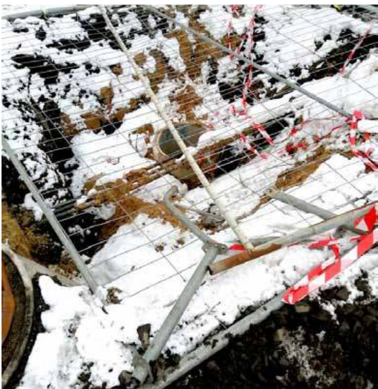
Nieodpowiednie, zdaniem mieszkańców, zabezpieczenie wykopów
