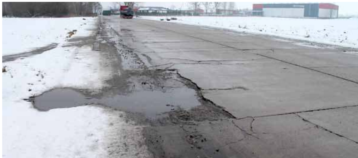
Zdjęcie sprzed kilku dni. Jak widać dokładnie, dziura nadal pozostaje zmartzeniem kierowców. Dziura zostanie załatwana, gdy tylko będzie wznowiona produkcja masy bitumicznej
