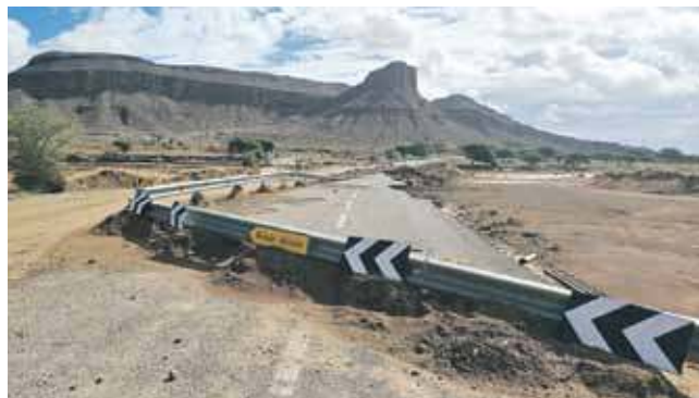
Powódź w Maroku zniszczyła wiele dróg.
