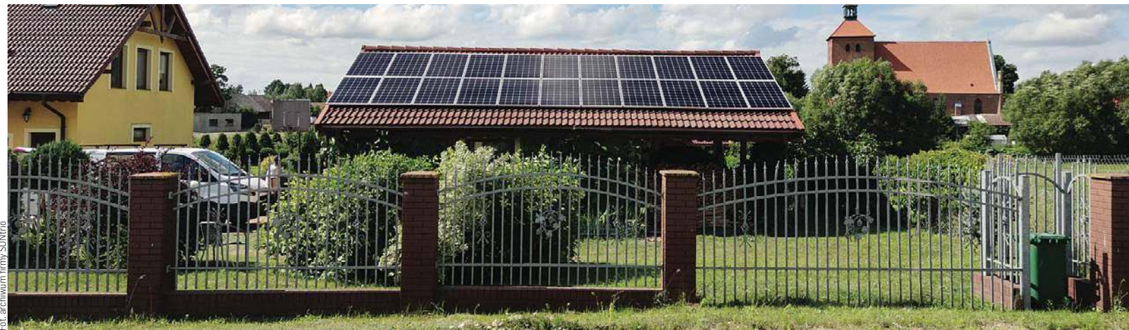
Instalacja fotowoltaiczna to same korzyści na wiele lat
