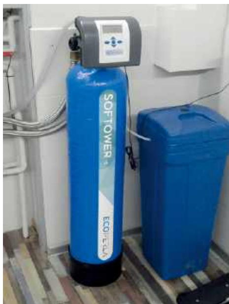
🔧 Dwuczęściowy zmiękcacz wody (butla z głowicą) i zbiornik na sól regeneracyjną. KLARSAN
