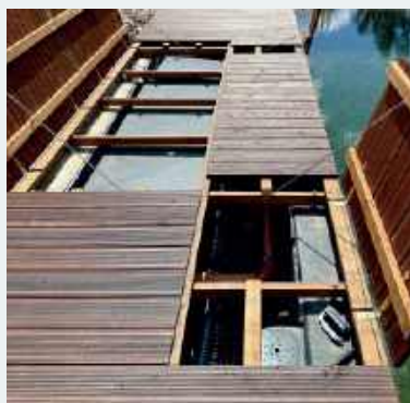
🔴 Otwierane klapy w pomoście, pod nimi system oczyszczania wody i studnia chłonna.
