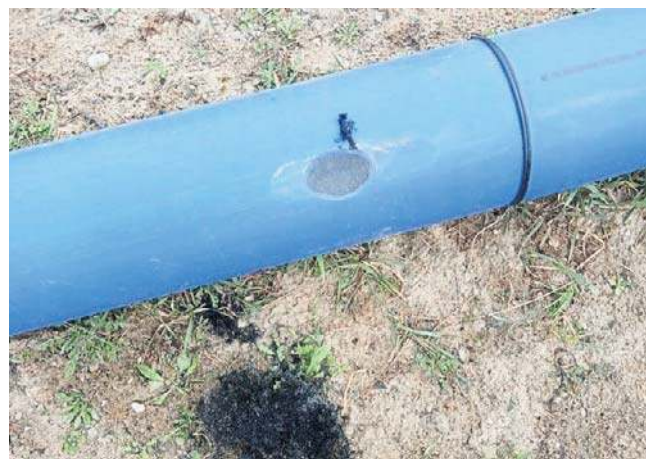
Uszkodzona rura przygotowana do montażu na odcinku budowy wodociągu Steżycza Huta - Steżycza
