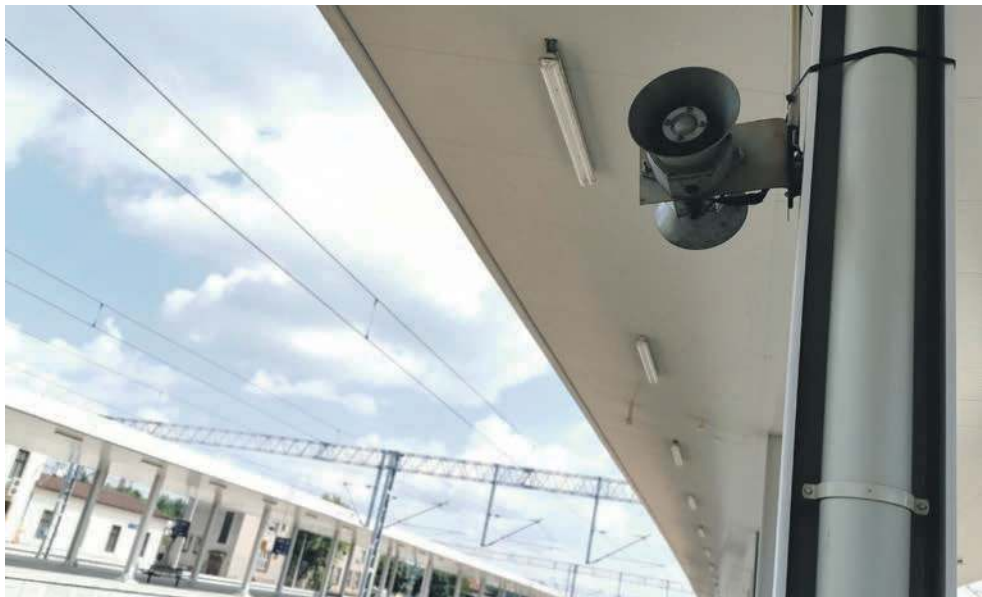
Na stacji kolejowej w Trzebini funkcjonuje obecnie tymczasowy, stary system nagłośnienia
