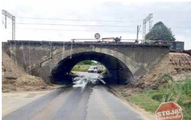
Od wczoraj wiadukt na ul. Składowej jest już zamknięty dla ruchu samochodów. Foto Stoja!Stargard
