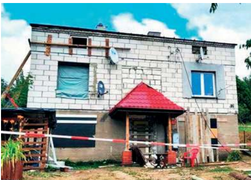
Budynek mieszkalny został poważnie uszkodzony
