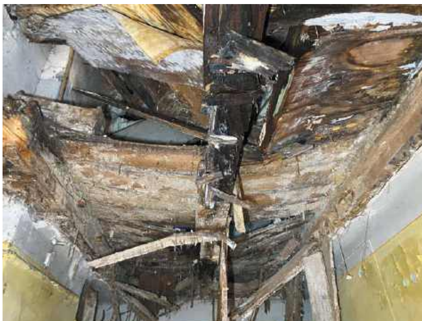
FOT. 1 Wymiana drewnianego stropu, który uległ awarii w wyniku działania stroczka domowego, przez co stracił zarówno właściwości użytkowe, jak i konstrukcyjne, nie podlega dyskusji; fot.: autor
