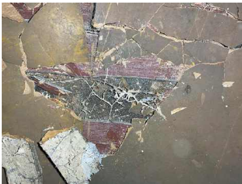
FOT. 3 Sznury grzyba domowego właściwego rozwijające się pod warstwami podłogowymi; fot.: autor
