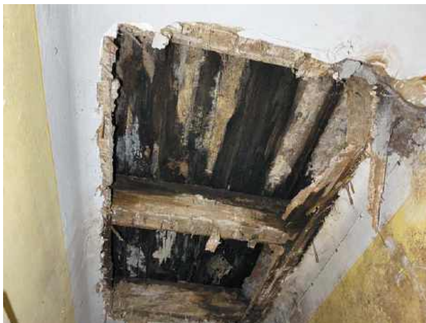
FOT. 2 Porażenie stropu drewnianego grzybem domowym niewidoczne do czasu odstąpienia konstrukcji; fot.: autor
