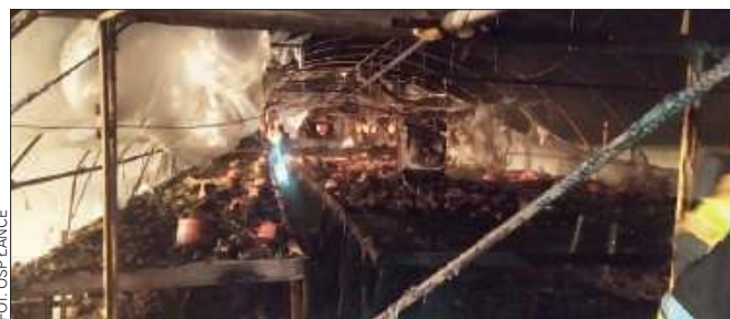
Zarzewiem pożaru szklarni była prawdopodobnie ogrzewnica na olej opałowy
