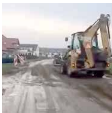
Remont drogi przeprowadzony w połowie grudnia 2021 nie zdał się na długo
