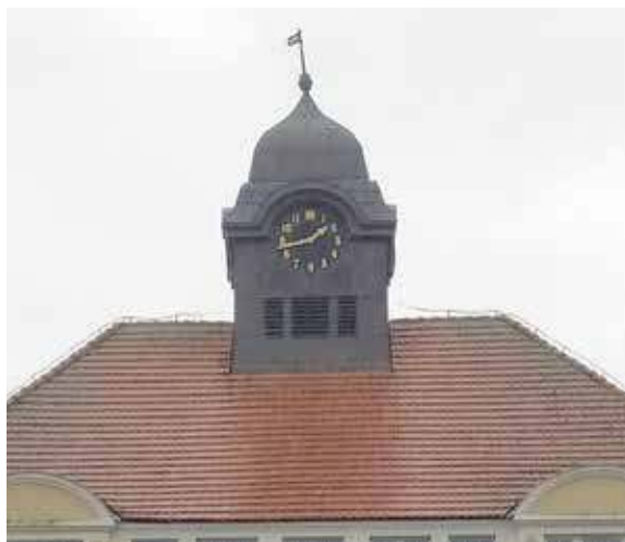
Iglica na szczycie ratusza zauważalnie odstaje od pionu
