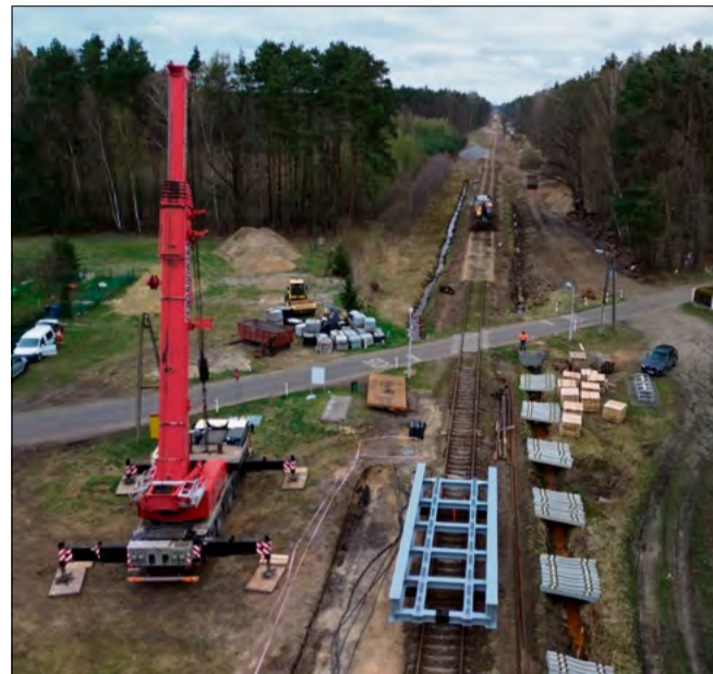
Modernizacja linii kolejowej Opole – Kluczbork nabiera tempa - prace prowadzone są m.in. na mostach, torach i peronach w północnej części powiatu opolskiego.
