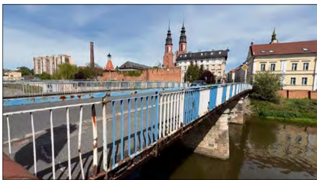
Przeprawa prowadząca do opolskiej katedry i centrum Starego Miasta czeka na remont.
