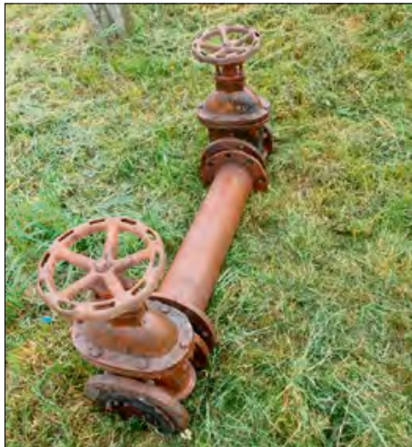
Stare urządzenia były już mocno wyeksploatowane.
