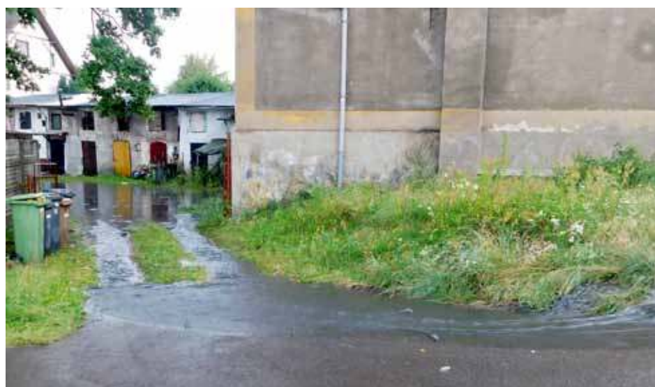
Na ul. Pileckiego niedrożne studzienki wylały fekaliami na podwórzu budynku wielorodzinnego
