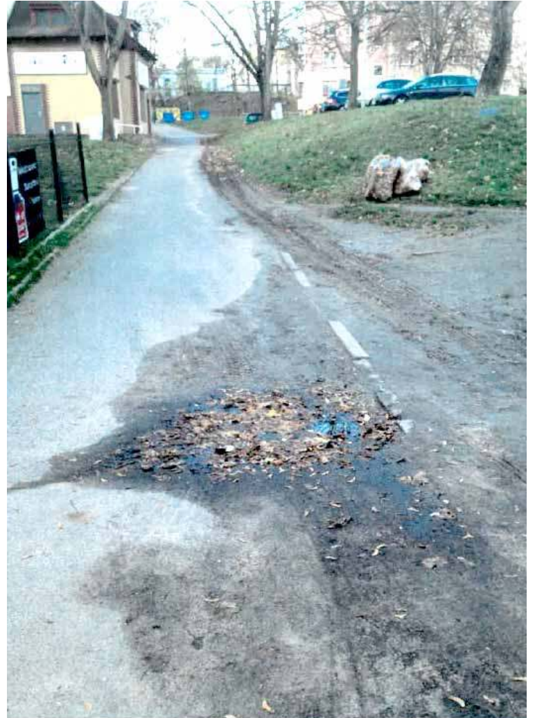
Stan drogi pozostawia wiele do życzenia. Uszkodzeniu uległa nawierzchnia asfaltowa i znajdująca się obok skarpa
