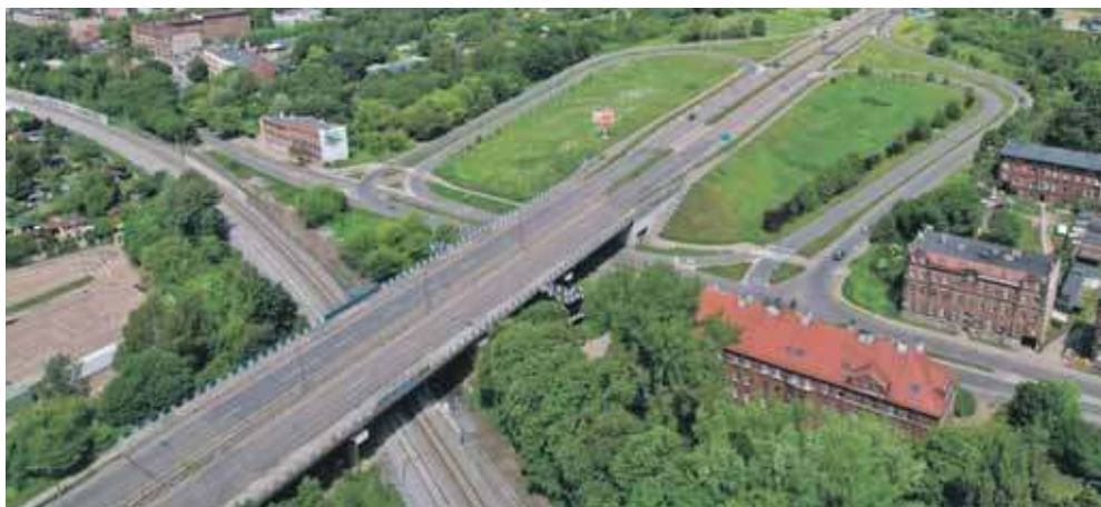
Wiadukt jest w kiepskim stanie technicznym
