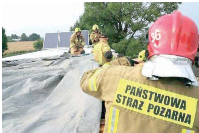
Strażacy mieli po nawałnicy sporo pracy. M.in. zabezpieczali plandekami uszkodzone dachy
