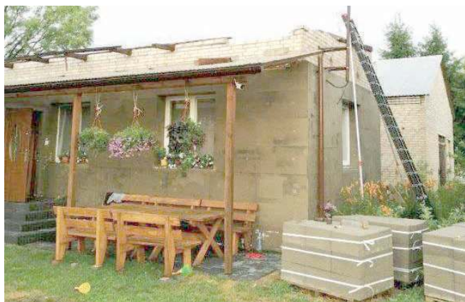
W Jasionce wiatr zerwał dach z jednego z domów
