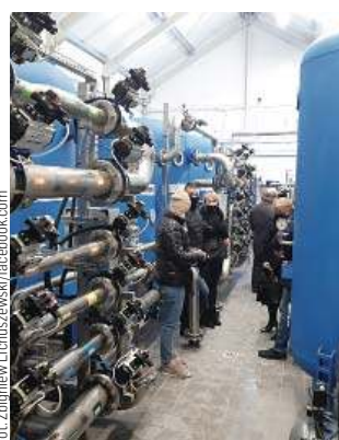
Nowoczesna stacja uzdatniania wody
