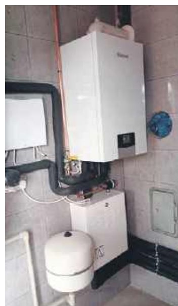
Koszt instalacji kotła gazowego to średnio 15 tys. zł. Fot. nadesłane
