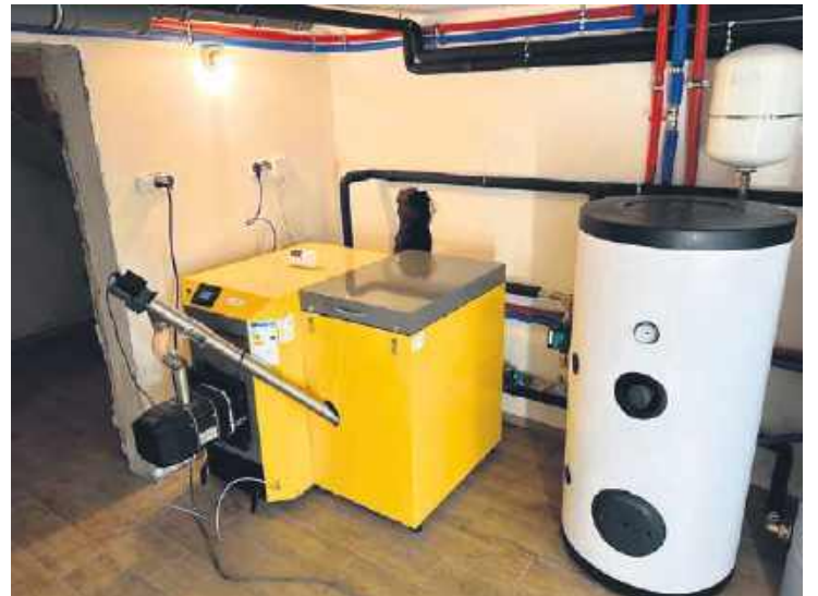
Przykładowy kocioł na pellet o mocy 20 kW, ogrzewający budynek o powierzchni 180 m 2 . Fot. nadesłane
