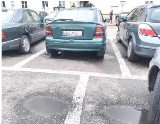
- Na Placu Narutowicza pojawiło się sporo dziur i wgłębień, które zatrzymują wodę po deszczu. Przez to trudno tam zaparkować, a pieszym ciężko przejść - interweniuje radny Sławomir Smolak
