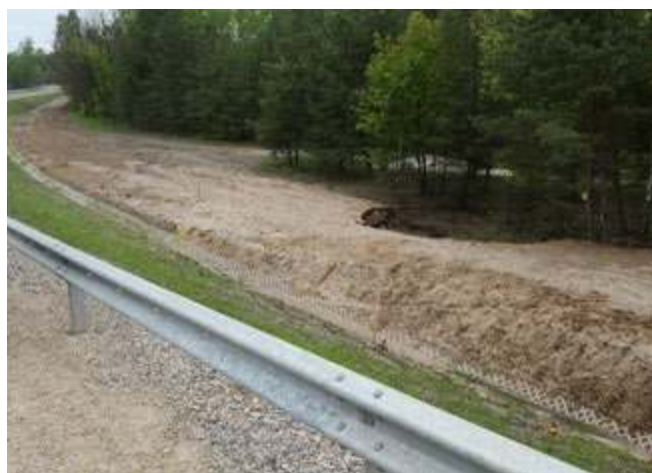
Fot. 2. Zapadlisko po płytcei podziemnej eksploatacji rud Zn-Pb w Bolesławiu k. Olkusza (maj 2023)
