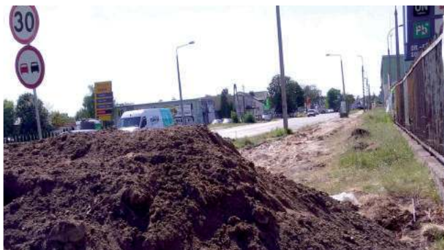
Od kilku tygodni przy skrzyżowaniu bialskich ulic Sidorskiej i Kapielowej widnieje taka blokada. Nie ma żadnego ruchu na przerwanej budowie. Zdjęto tam jedyny przy ulicy chodnik i piesi muszą wychodzić na jezdnię, gdzie panuje duży ruch
