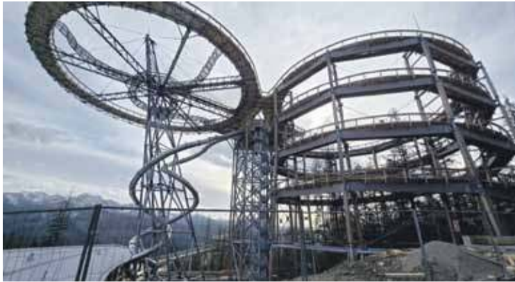
Sky Walk Serce Poronina to trasa długości 854 metrów z platformami widokowymi na wysokości 47 metrów
