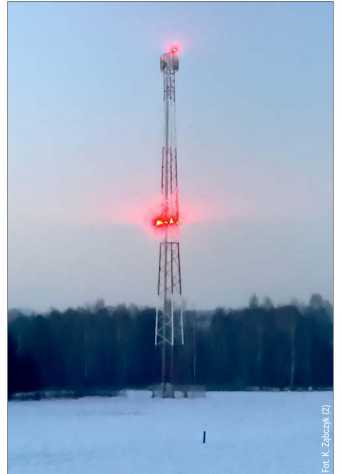
Tak wygląda maszt po zmroku. Znajduje się on po północnej stronie Wojkowa, w polach za torami w kierunku Kłapówki.
