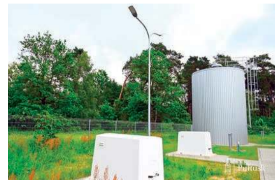
Stacja uzdatniania wody
