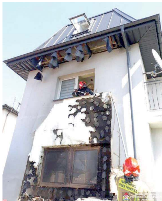
Po ugaszeniu pożaru strażacy rozebrali część nadpalonej konstrukcji
