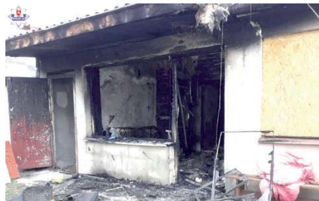
Tym razem w wyniku pożaru na ul. Krótkiej życie straciła 65-letnia mieszkanka Puław. Jej ciało strażacy znaleźli przed płonącym budynkiem
