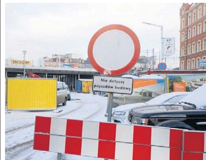
Tak wygląda przebudowywany wiadukt przy ulicy Mikołowskiej. Od 23 stycznia złączą tędy jeździć auta
