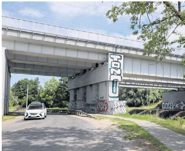
Asfalt pod wiaduktem i w najbliższym jego sąsiedztwie jest w bardzo złym stanie - uważa nasz Czytelnik
