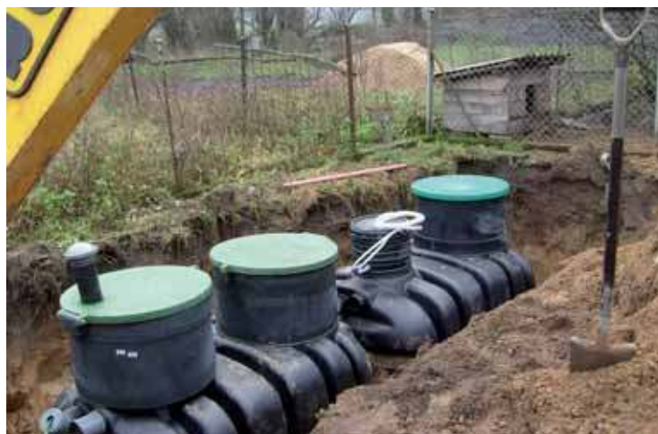
Przydomowe oczyszczalnie, gm. Dzierżążnia
