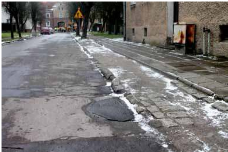
Chodnik wymaga nie tylko naprawy, ale również uzupełnienia
