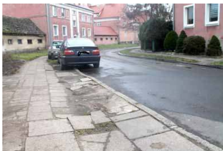
Na ul. Łużyckiej chodnik w wielu miejscach też wymagałby remontu
