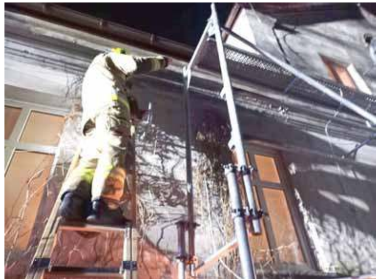
W poniedziałek strażacy zostali zadysponowani do zabezpieczenia konstrukcji rusztowania na fasadzie budynku. Foto. OSP. Stara Dąbrowa
