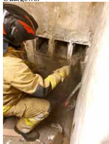
W minioną środę strażacy zostali zadysponowani do miejscowości Lutkowo, gdzie doszło do pożaru sadzy w przewodzie kominowym. Foto. OSP. Dobrzany
