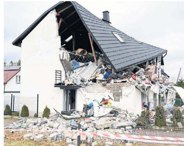
Po niedzielnym wybuchu gazu w domu w Brzezinkach budynek nie nadaje się do zamieszkania
