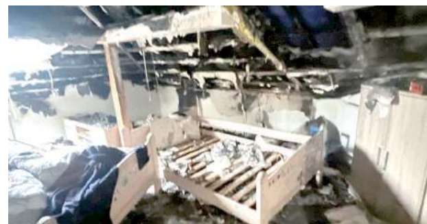
Spłonęło także wyposażenie domu
