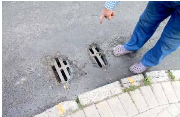
Z powodu zalanych asfaltem wpustów mieszkańcy obawiają się jeszcze większych podtopień piwnic po ulewach
