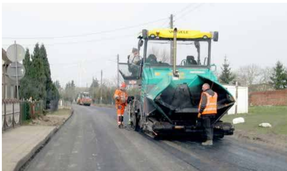
Najbardziej dziurawa droga w powiecie - Żelechowo, właśnie została naprawiona
