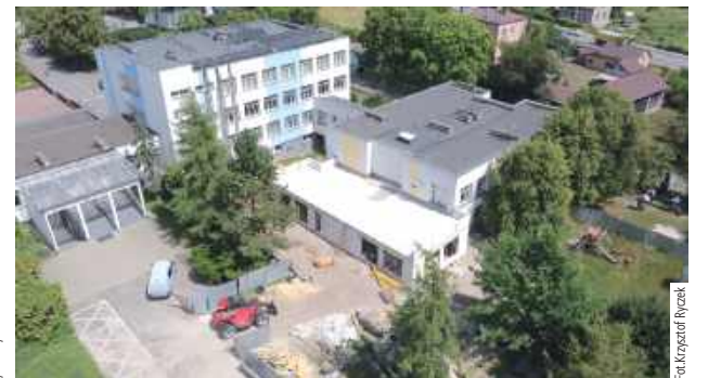
Budowa nowego obiektu żłobka przy Szkole Podstawowej nr 1 w Opolu Lubelskim jest w stanie surowym otwartym
