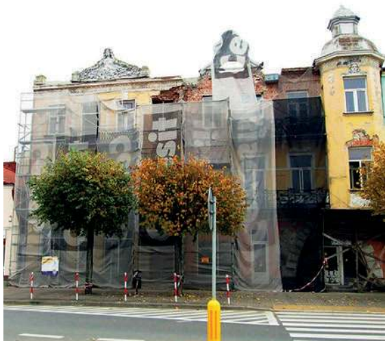
Tak wygląda stan aktualny zabytkowej ściany frontowej
